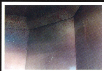
従来のプラントミキサー内部
